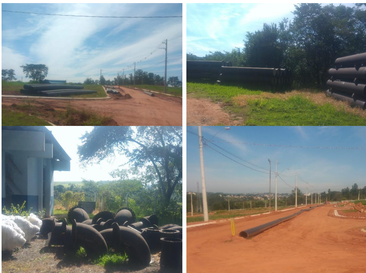
Obra da Adutora de Água Bruta em tubos de ferro fundido DN 600mm
