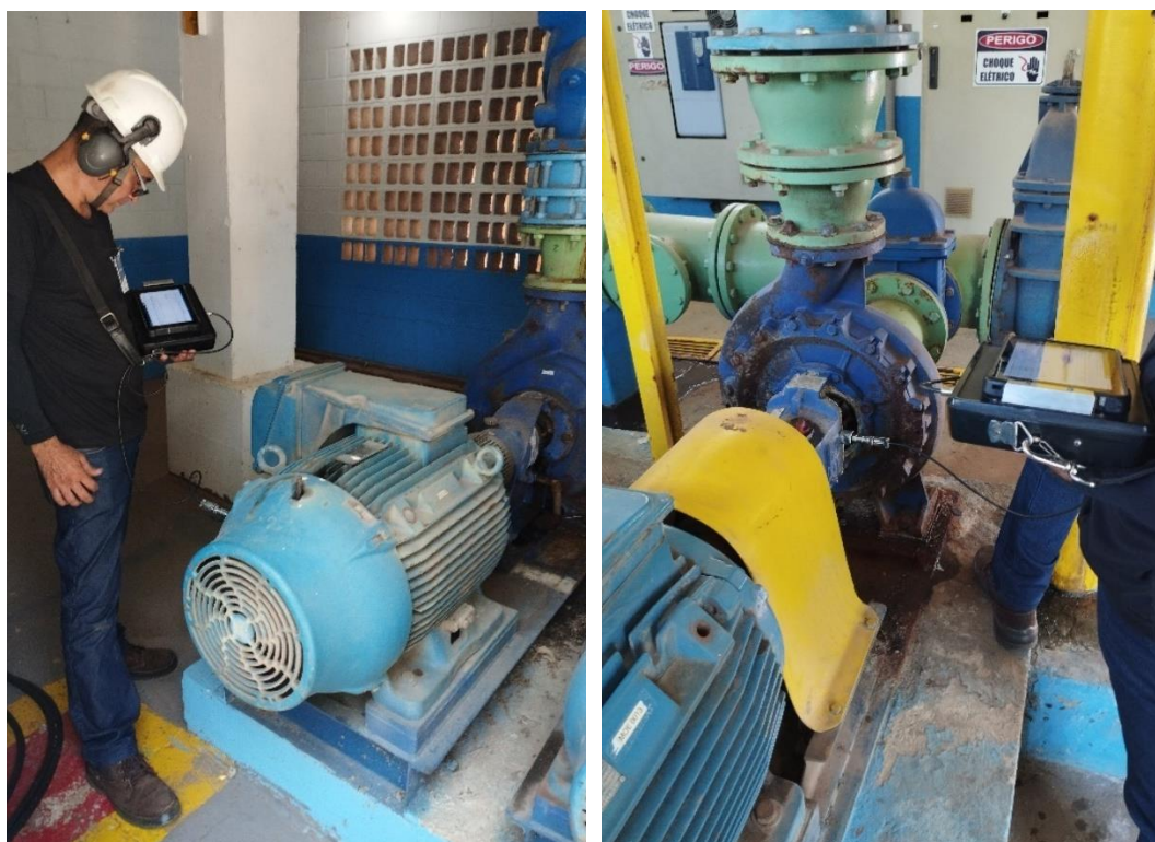
Figura 2. Análise de vibração em conjuntos motobomba.
