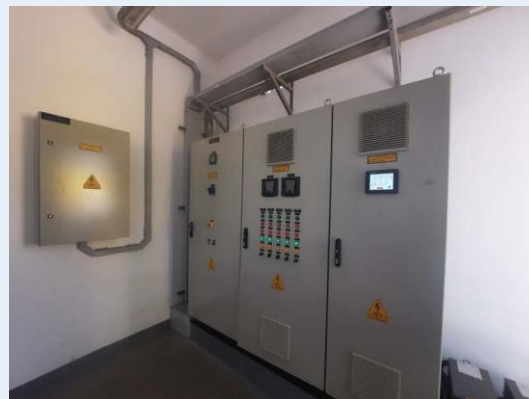
Figura 2: Painel de comando e controle do sistema de dosagem de hipoclorito de sódio da EEAB Jaguari
