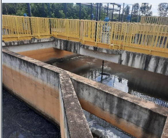
Figura 21: Vista superior do tratamento físico-químico
