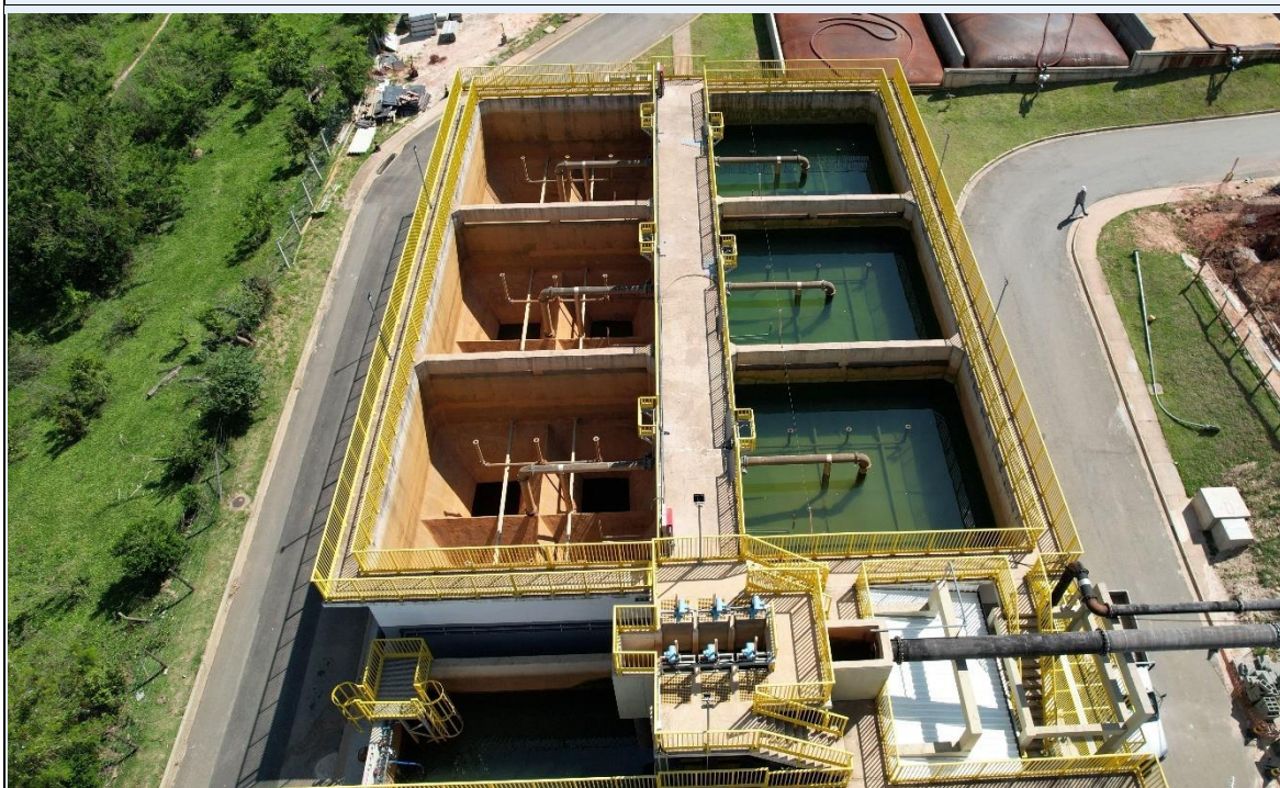
Figura 9: Imagem drone do tanque de adensamento de lodo (nov22)
