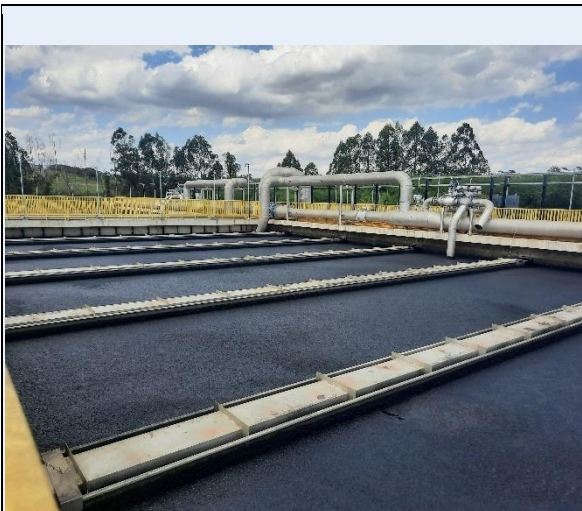
Figura 23: Vista superior do sistema de tratamento Nereda
