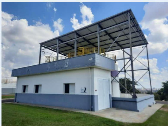
Figura 16: Sistema de dosagem de hipoclorito de sódio na ETA
