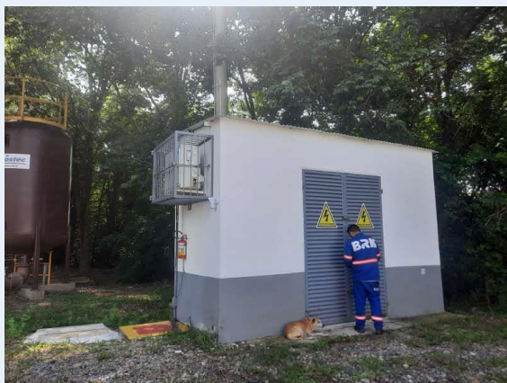
Figura 28: Abrigo dos painéis de comando e controle da EEEB Graminha
