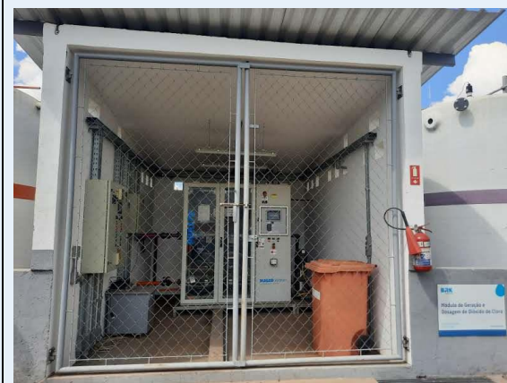
Figura 15: Gerador de Dióxido de Cloro
