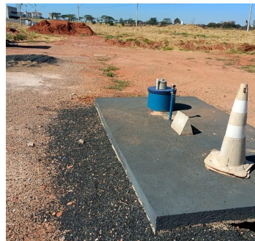
Foto 4 – Vista do poço 4 do Contrato (Polo Tecnológico).
