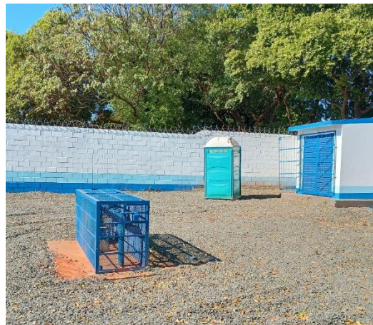
Foto 2 – Vista do poço 2 do Contrato (Solo Sagrado) e, ao fundo, abrigo do painel elétrico e de comando.
