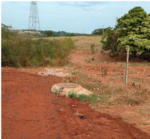
Foto 1 – Primeiro e segundo PVs do interceptor, próximo ao loteamento.
