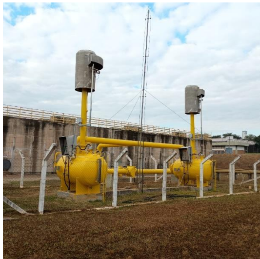
Foto 1 – Vista dos dois queimadores de biogás tipo flare na ETE Rio Preto.
