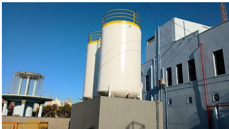
Foto 1 – Tanques de armazenamento de hidróxido de cálcio na ETA Palácio das Águas.
