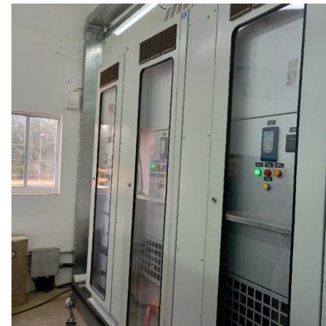
Foto 3 - Painéis elétricos da estação elevatória de esgoto.
