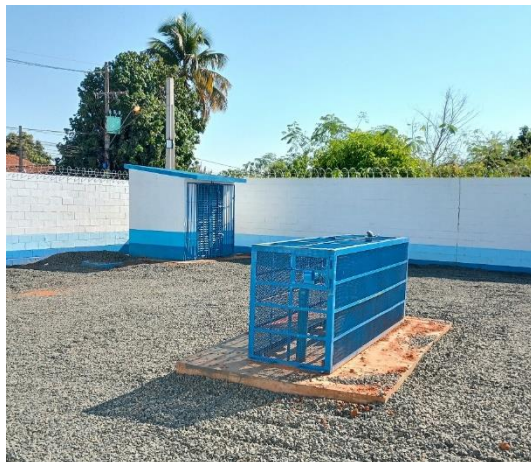
Foto 1 – Vista do poço 1 do Contrato (Solo Sagrado) e, ao fundo, abrigo do painel elétrico e de comando.
