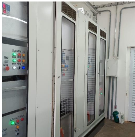
Foto 2 - Painéis elétricos da estação elevatória de esgoto.
