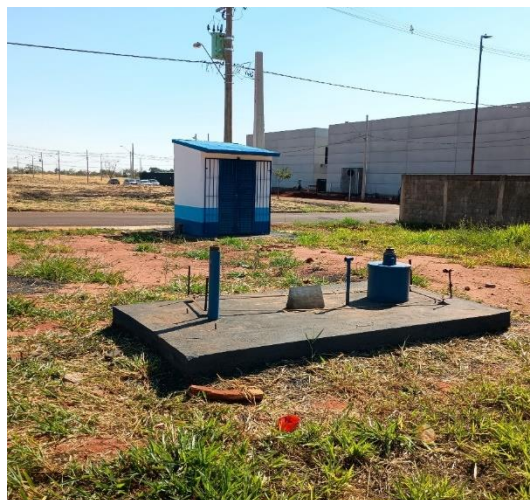
Foto 3 – Vista do poço 3 do Contrato (Polo Tecnológico) e, ao fundo, abrigo do painel elétrico e de comando.
