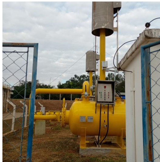
Foto 2 - Vista dos dois queimadores de biogás tipo flare na ETE Rio Preto.
