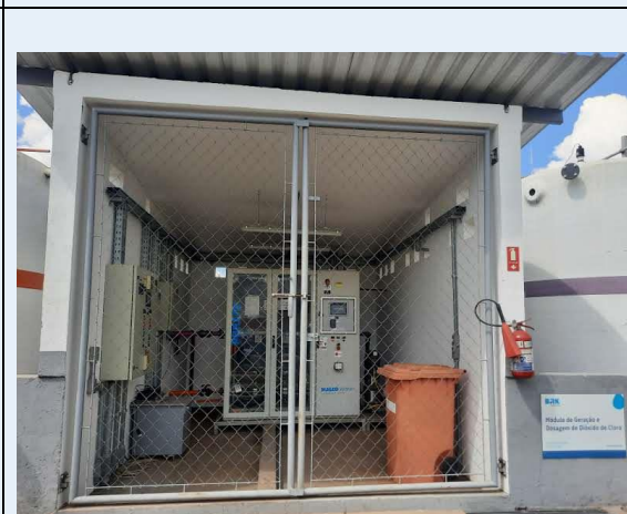
Figura 15: Gerador de Dióxido de Cloro
