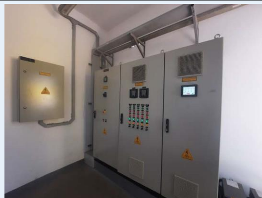
Figura 2: Painel de comando e controle do sistema de dosagem de hipoclorito de sódio da EEAB Jaguari
