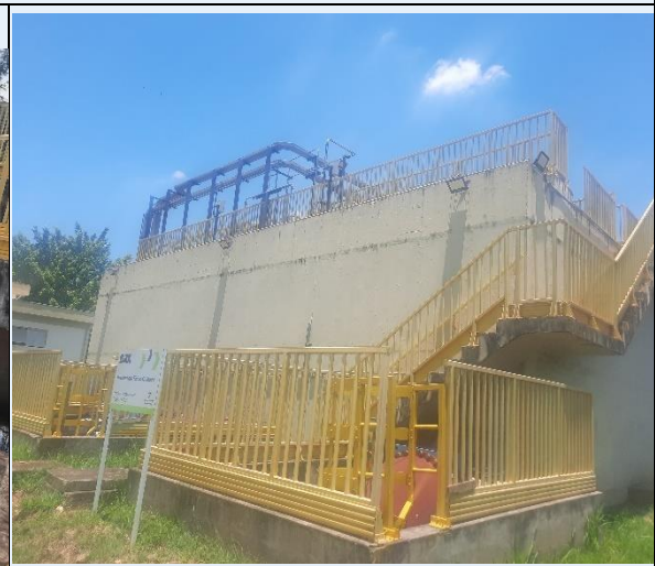
Figura 22: Vista lateral do tratamento físico-químico
