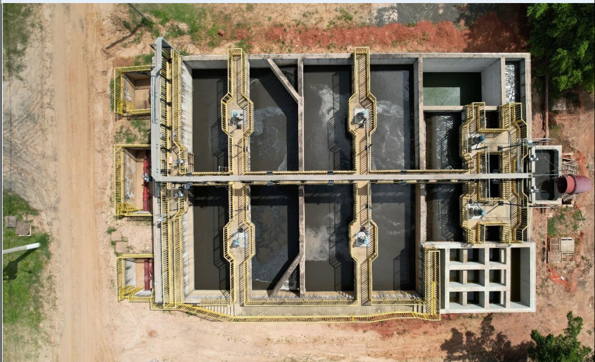
Figura 19: Imagem de drone do tratamento físico-químico (nov22)
