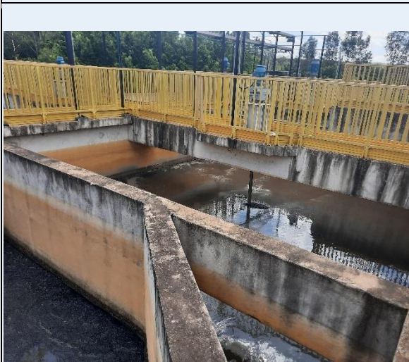
Figura 21: Vista superior do tratamento físico-químico
