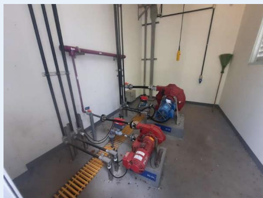
Figura 3: Bombas dosadoras de hipoclorito de sódio
