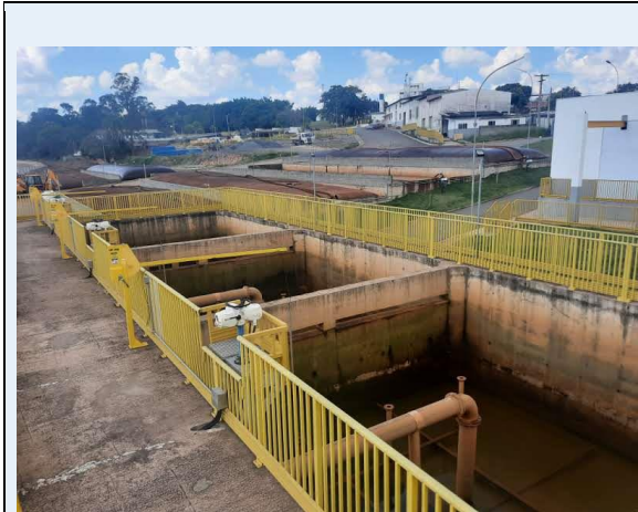
Figura 10: Tanques de adensamento
