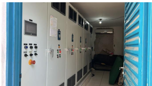
Foto 5 - Novos painéis elétricos da elevatória.
