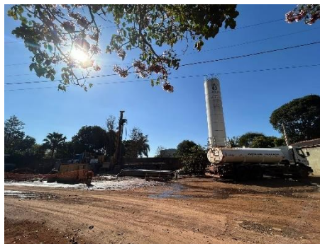
Foto 2 - À direita, abastecimento do reservatório com caminhão pipa. À esquerda, local onde está sendo perfurado o novo poço.
