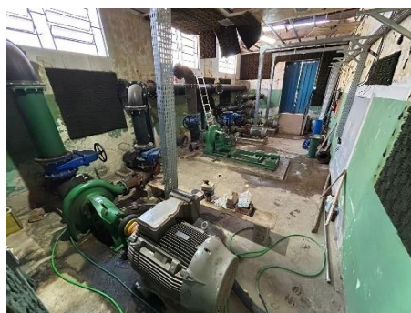
Foto 6 - Conjuntos motobomba da EEAT Jd. Santa Rosa
