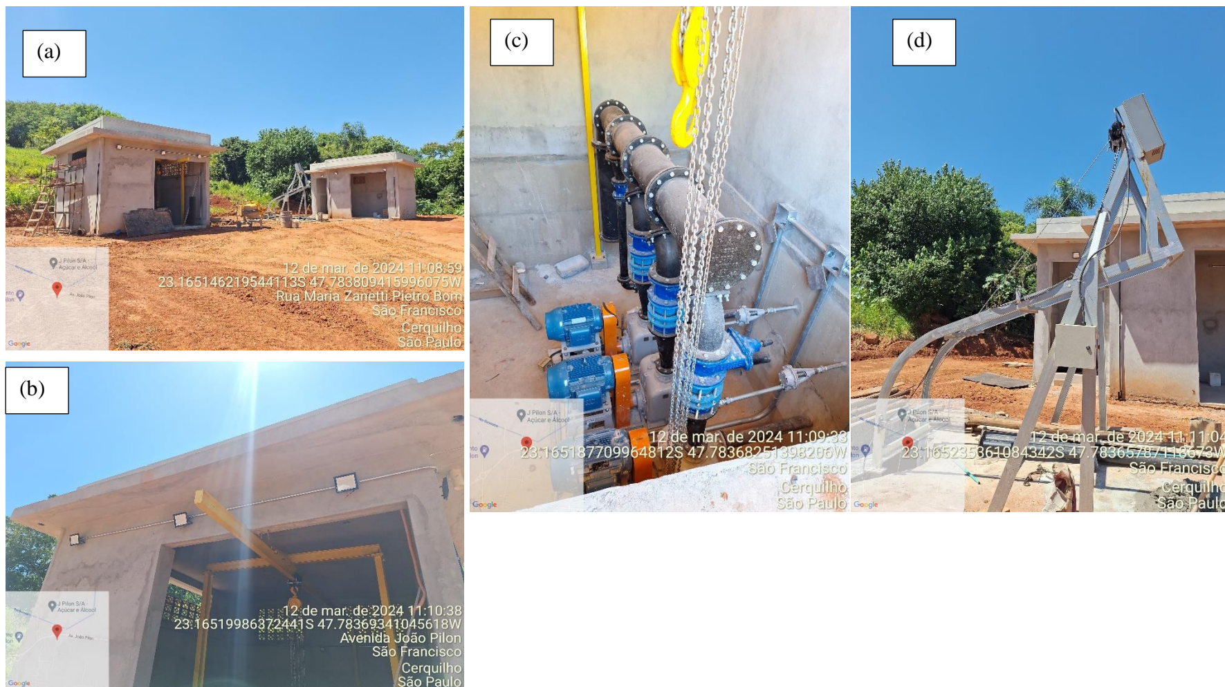
Figura TEC 4: Estação Elevatória de Esgoto EEE - Córrego (Execução das obras da 2ª etapa da bacia do córrego cachoeira – FEHIDRO) (a) Visão geral EEE; (b) acesso aos conjuntos motobomba; (c) conjuntos motobomba instalados; (d) gradeamento mecanizado
