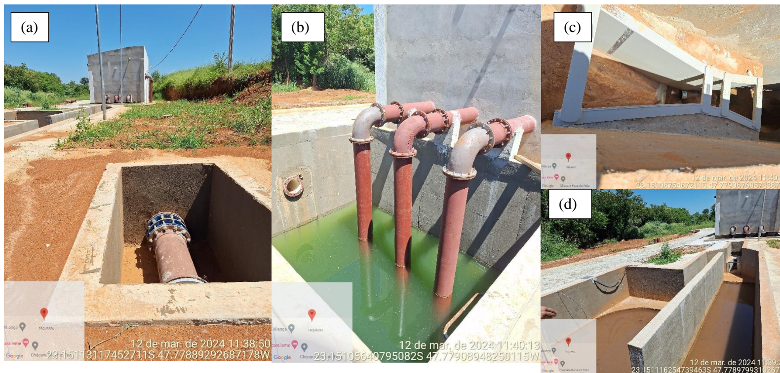
Figura TEC 5: Execução das obras do sistema de esgotamento de efluentes para a Bacia do Córrego Cachoeira em Cerquilha/SP – 3ª etapa (Estação Elevatória de Esgoto da Estação de Tratamento de Esgoto Rio Sorocaba) – (a) visão geral – chegada da EEE; (b) poço de sucção da EEE; (c) medidor Parshall – chegada de esgoto; (d) desarenador da EEE
