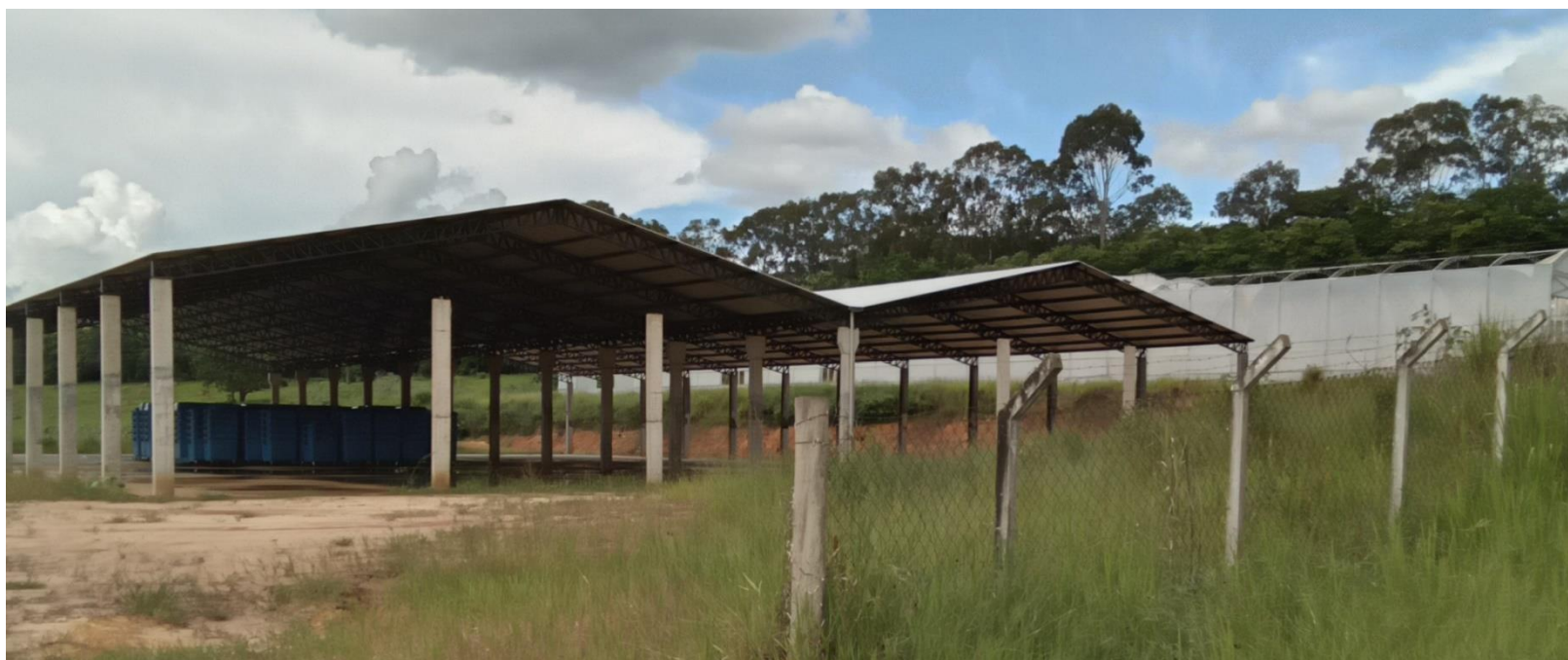
Figura TEC 2: Galpão para armazenamento do lodo de ETE e Estufa de secagem ao fundo. Estufa de secagem com cobertura comprometida (fev. de 2023).
