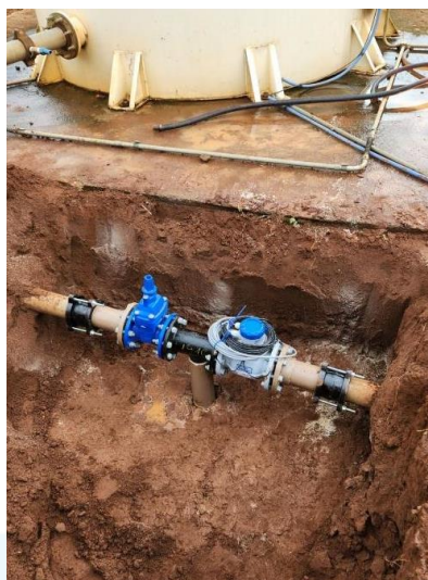
Foto 3 – Macromedidor instalado na saída/chegada de um dos reservatórios elevados do Distrito de Patrimônio (Fonte: Thesis Eng., 2024).
