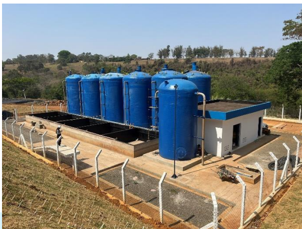
Foto 3 – Vista geral da ETE Compacta (Fonte: SAAEB, 2024).
