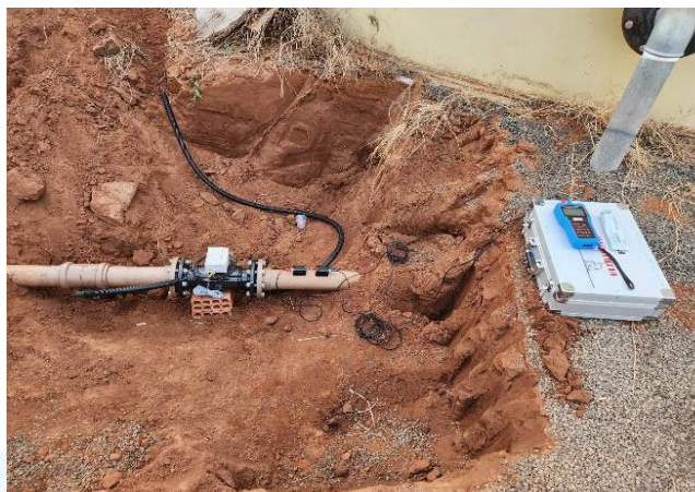
Foto 3 – Medidor ultrassônico instalado (Fonte: Thesis Eng., 2024).
