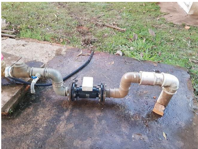
Foto 1 – Macromedidor de vazão instalado (Fonte: Thesis, 2024).
