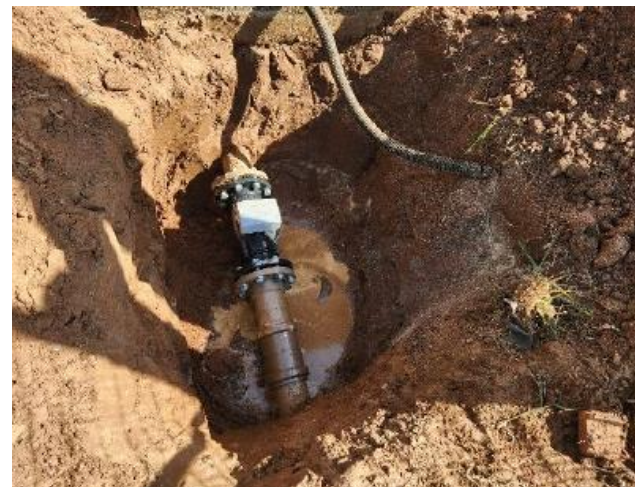
Foto 2 – Macromedidor de vazão instalado (Fonte: Thesis, 2024).
