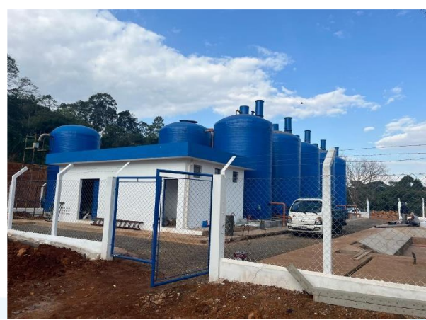
Foto 4 – Vista geral externa da ETE Compacta (Fonte: SAAEB, 2024).
