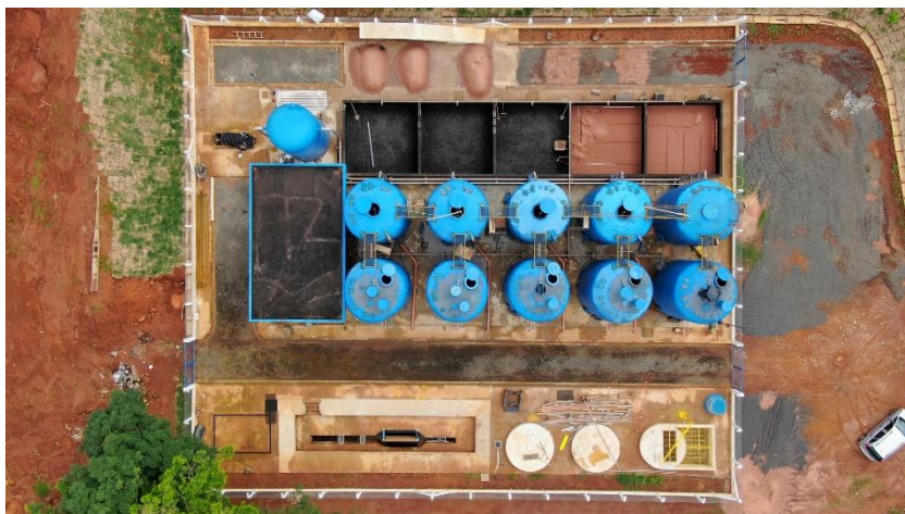
Foto 1 – Vista aérea da ETE Compacta instalada na ETE Cidade.
